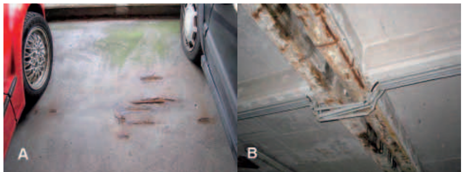
Bild 1: Typische Schadensbilder in Parkhäusern
